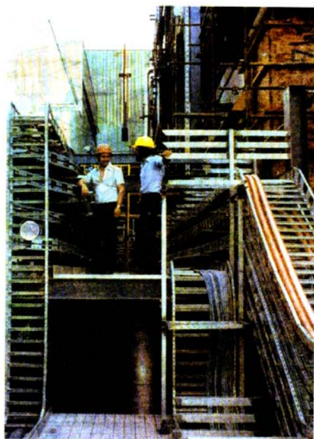
چگونگی عبور کابل از ریل‌ها و کانال‌های فلزی
